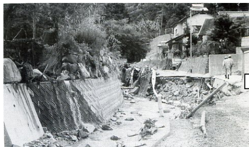
宮風呂付近の荒谷川と道の被害状況
