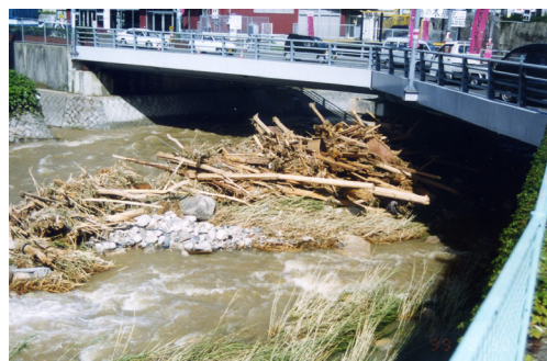
藤の木橋の橋脚の流木
