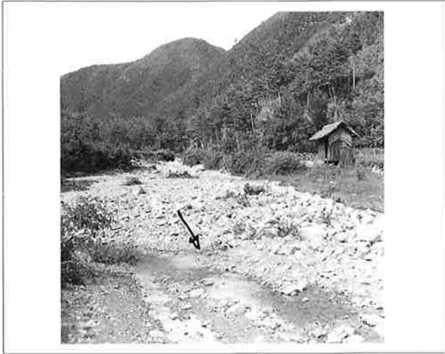
撮影日：S.27.7.18 撮影場所：三原市 撮影者：佐久間 通常堰堤下 新しい井堰より上流堆積状況
