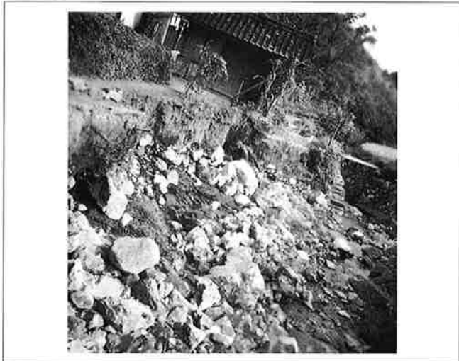
撮影日：S.27.8.29 撮影場所：比婆郡西城町 撮影者：阿座上 下流護岸欠壊（道路がなくなっている）
