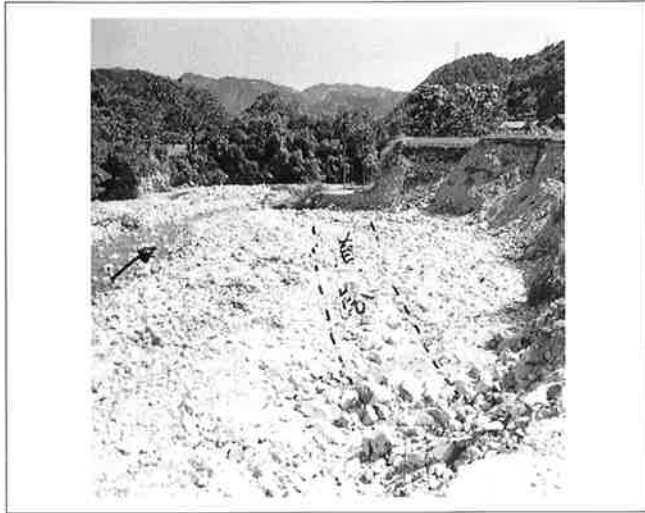
撮影日：S.27.7.18 撮影場所：三原市 撮影者：佐久間 上流橋梁より上 第二番目道路流失箇所
