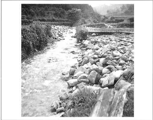
撮影日：S.27.7.14朝 撮影場所：豊田郡大乘村 撮影者：坂田 上流における護岸欠壊状況
