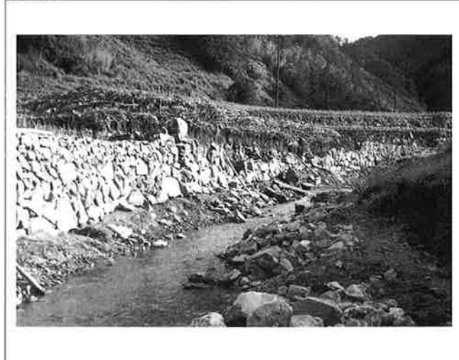
撮影日：S.27.7.16 撮影場所：芦品郡有磨村 撮影者：阿座上 上流 河床洗掘され単胴木が浮いている
