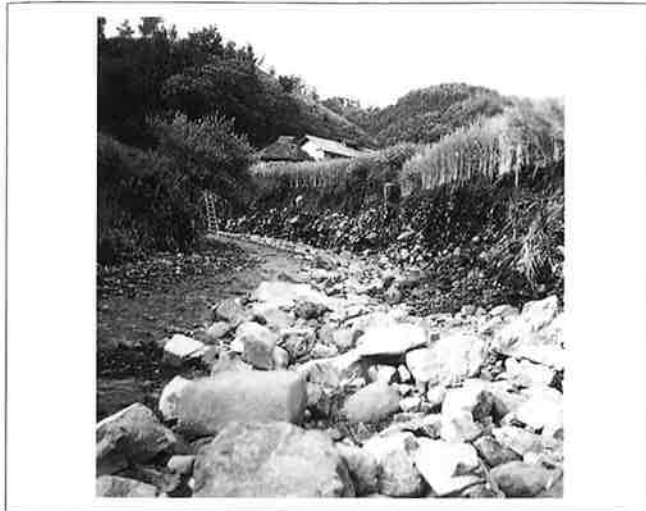
撮影日：S.27.8.29 撮影場所：比婆郡西城町 撮影者：阿座上 下流護岸決壊（道路がなくなっている）
