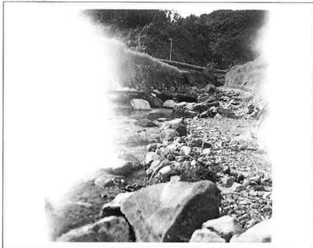
撮影日：S.27.8.29 撮影場所：比婆郡西城町 撮影者：阿座上 下流護岸決壊（道路がなくなっている）
