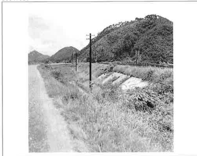
撮影日：S.27.7.19 撮影場所：豊田郡長谷村・本郷町・高坂村 撮影者：佐久間 小坂川合流点付近山陽線鉄道線路湛水跡
