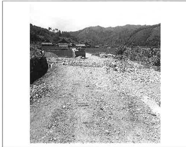
撮影日：S.27.8.3 撮影場所：比婆郡西城町 撮影者：高田 昭和27年7月29・30日豪雨に依る県道埋没状況 29日12時～30日3時まで3時間雨量217mm
