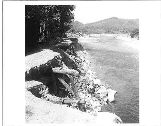
撮影日：S.27.8.3 撮影場所：比婆郡高村 撮影者：高田 昭和27年7月29・30日の豪雨に依り指定府県道の欠壊の状況 上より下へ
