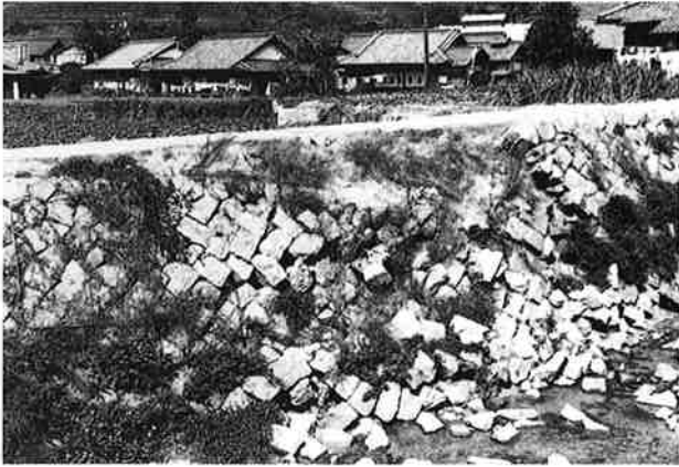
撮影日：不明 撮影場所：安芸郡坂町 撮影者：不明
