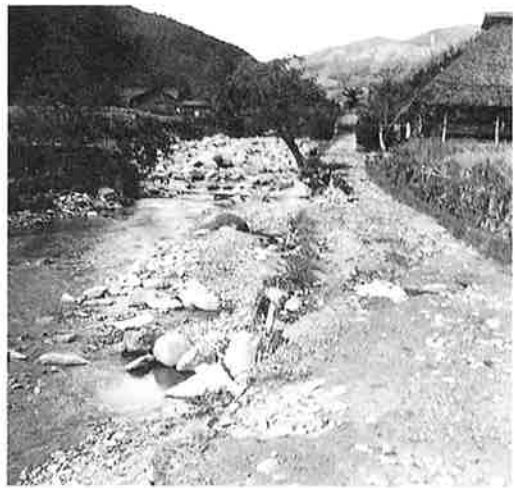
撮影日：S26.10.22 撮影場所：佐伯郡玖島村 撮影者：川口技師 中流部 護岸欠壊状況 2
