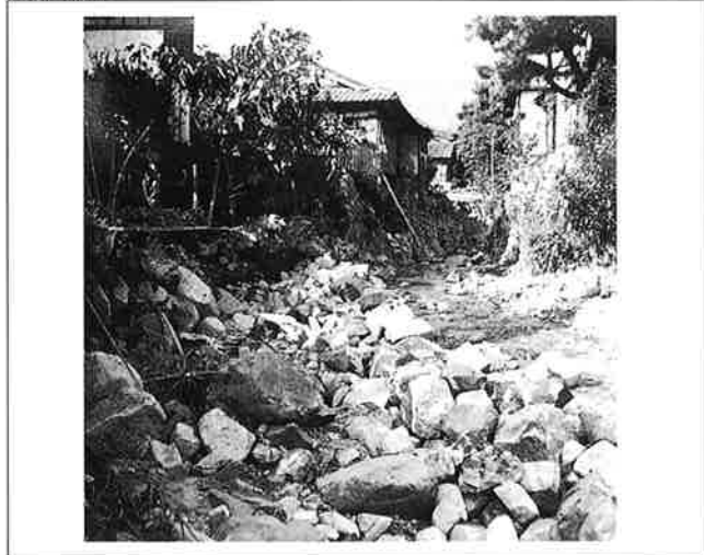
撮影日：S26.10 撮影場所：呉市辰川町 撮影者：高田技師 辰川下流部護岸欠壊状況
