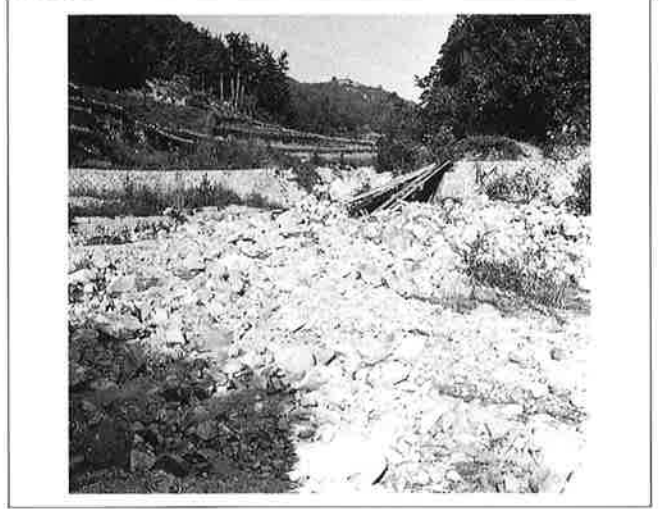
撮影日：S26.10 撮影場所：呉市 撮影者：高田技師 上流部 堰堤上流（昭22.施工）の荒廃状況 落橋しているのは県道路橋
