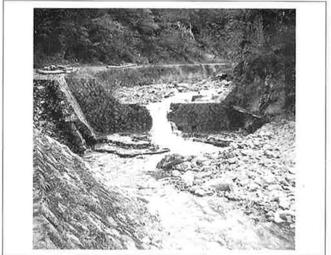
撮影日：S26.11.3 撮影場所：山県郡大朝町 撮影者：坂田 昭和6年砂防工事の床止の破損が多い 山崩なし 1
