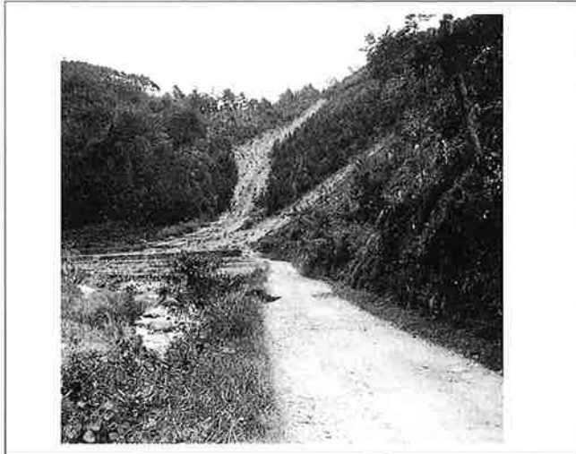
撮影日：S26.10.22 撮影場所：佐伯郡玖島村 撮影者：川口技師 下流より崩壊状況を見る A
