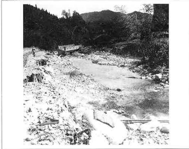
撮影日：S26.10.22 撮影場所：佐伯郡玖島村 撮影者：川口技師 中流部 家屋、護岸、橋梁等の欠壊流出状況を上流より望む 3
