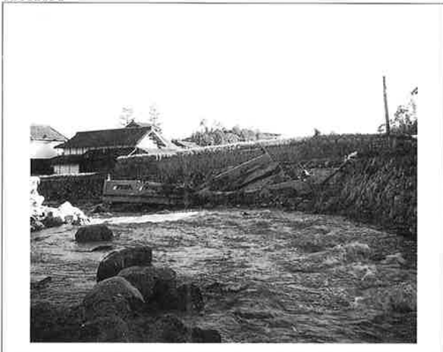
撮影日：S26.10.16 撮影場所：佐伯郡平良村 撮影者：桜井技師 速谷橋の落橋
