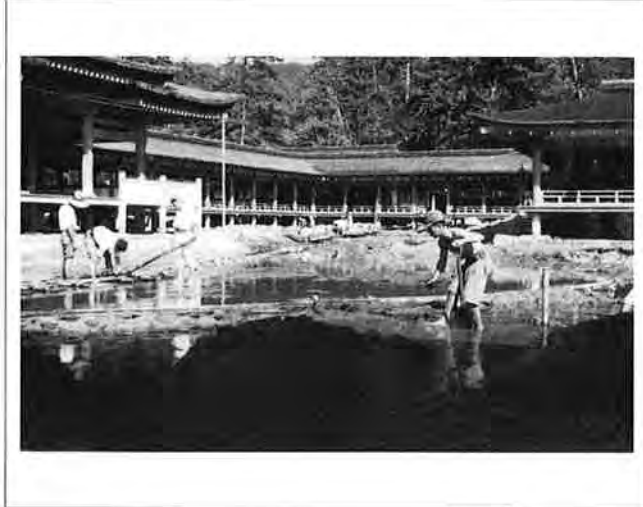
撮影日：S22,7,28 撮影場所：佐伯郡巖島町 撮影者：藤岡 勝 柵型掘削及軌道修理 整理中の己斐二郎、軌道修理中の沖本正一
