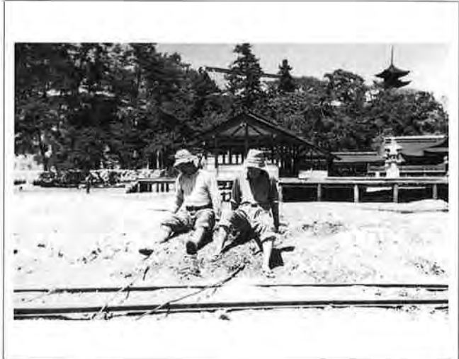
撮影日：不明 撮影場所：佐伯郡巖島町 撮影者：藤岡 勝 スクレパーによる土よせ作業
