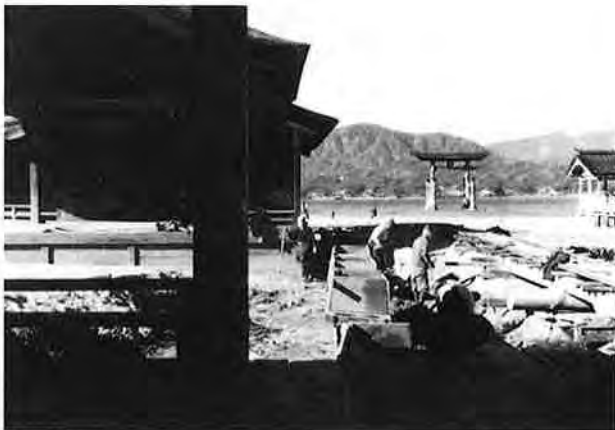
撮影日：S23.2 撮影場所：佐伯郡巖島町 撮影者：藤岡 勝 能舞台付近 土砂搬出作業
