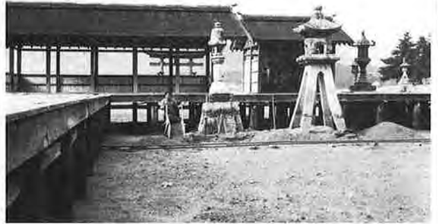
撮影日：S23.12 撮影場所：佐伯郡巖島町 撮影者：藤岡 勝 平舞台付近 土砂搬出
