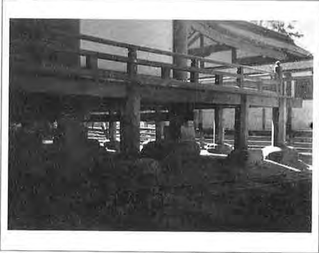
撮影日：S22.12 撮影場所：佐伯郡巖島町 撮影者：藤岡 勝 完成した本殿西側
