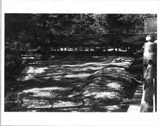
撮影日：S23 撮影場所：佐伯郡巖島町 撮影者：藤岡 豊 反橋西側の災害状況
