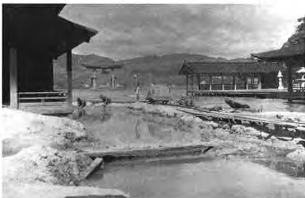
撮影日：不明 撮影場所：佐伯郡巖島町 撮影者：藤岡 勝 満潮時の作業場（廻廊奥反橋付近の土砂を搬出）
