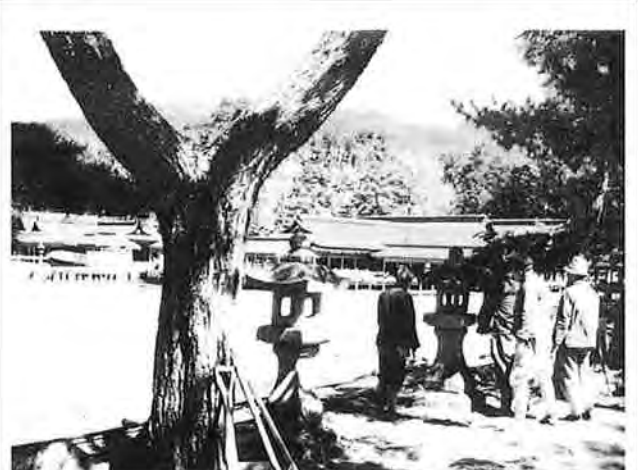
撮影日：不明 撮影場所：佐伯郡巖島町 撮影者：不明 西松原燈籠建立修理作業
