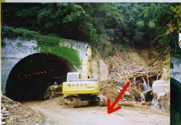
土石流が道路を横切り下流の民家を直撃した。
