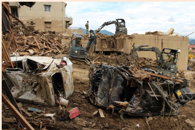
被害の状況【4】 提供:小原山町内会
