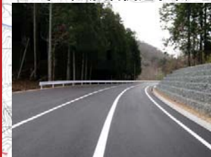
道路災害関連事業 一般県道中迫川北線 L=5.38km
