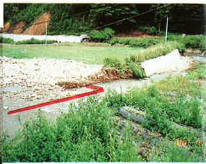
破堤した状況
