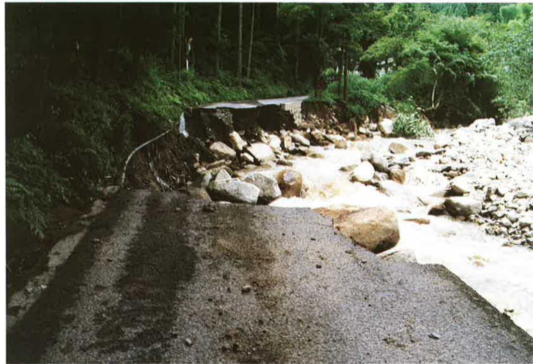
深山川の増水により流失した県道
