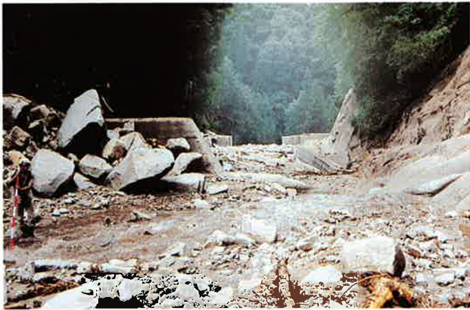
土石流により壊れた治山ダム 激しい土石流によって、堰堤の右側が破壊されている。下流が工事中の砂防ダム。
