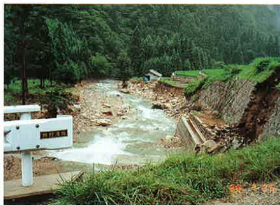
護岸欠壊状況
