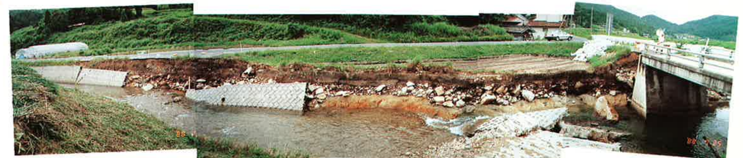
護岸欠壊状況
