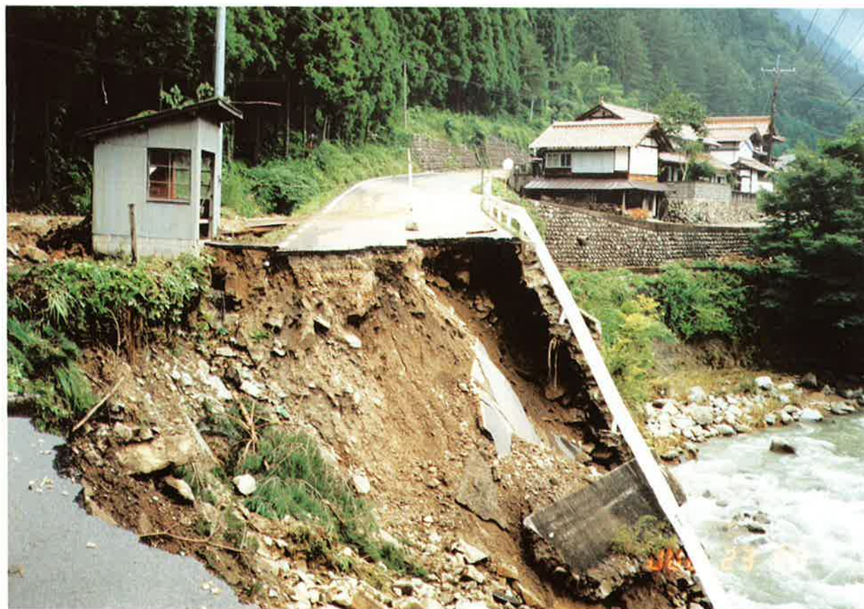
板ヶ谷川の増水により流失した国道
