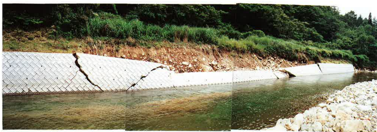
護岸の欠壊状況
