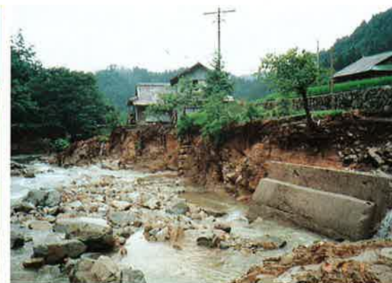
護岸欠壊状況
