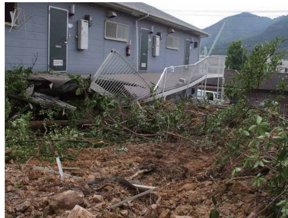
大量の土砂で一階部分が埋ったアパート
