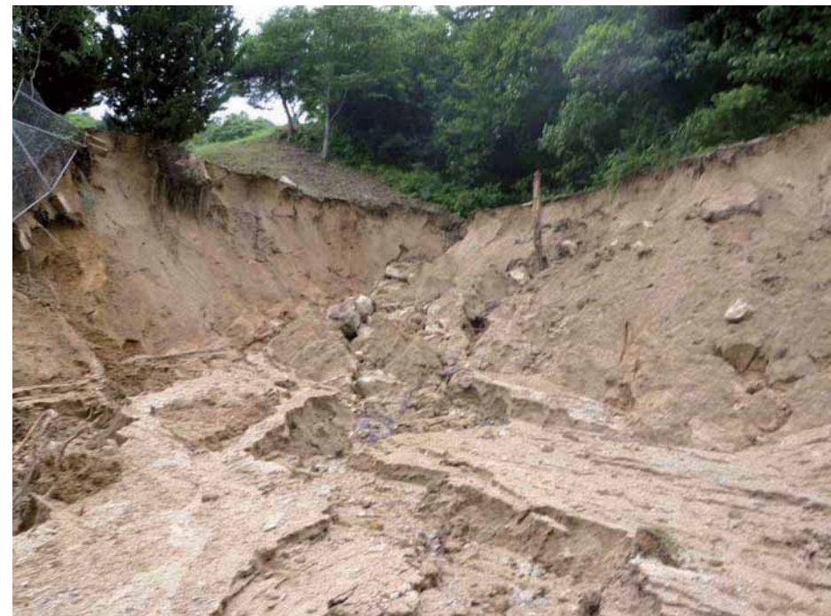
上流部土砂流出状況
