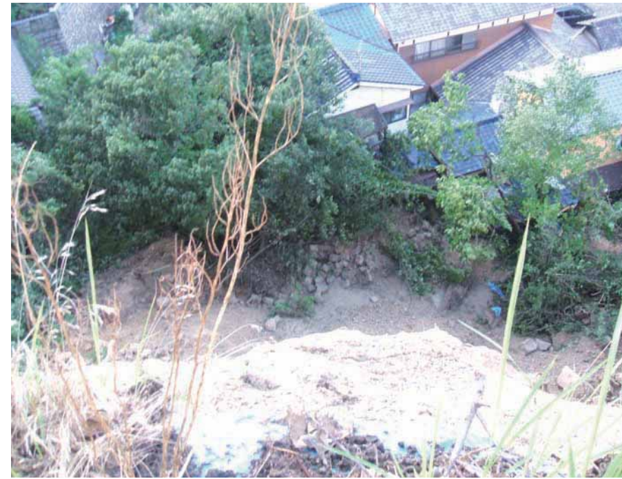
斜面上部より見た被災家屋
