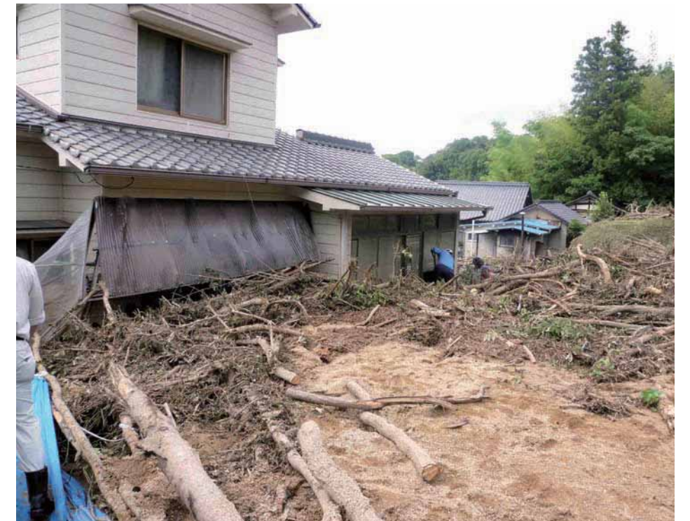
土石流による被害状況
