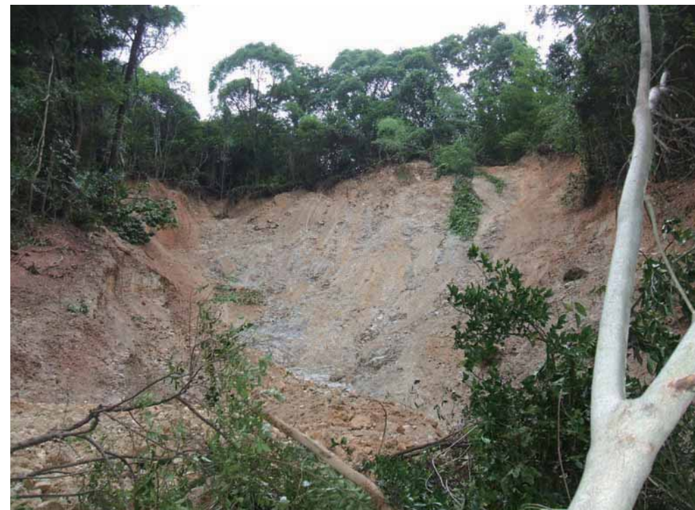
崩壊斜面の状況
