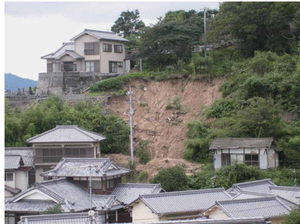
崩壊した斜面上部の状況
